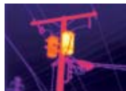
Перегретый полюс трансформатора
